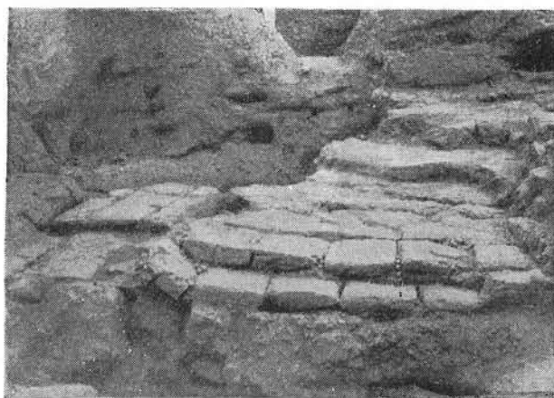
Тешик-кала. Раскопки наверху жилой башни. 1. Рухнувшие арки входов в центральное помещение из комнат №№ 7 и 4. 2—3. Кладка стен над древним помещением в основании донжона. 4. То же—видна деформация стен.
